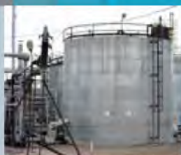
Unité de BITUMES
